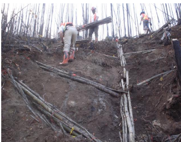
Figure 2-28: Fagots principaux et latéraux mis en place avant remblayage © Terra Erosion Control
