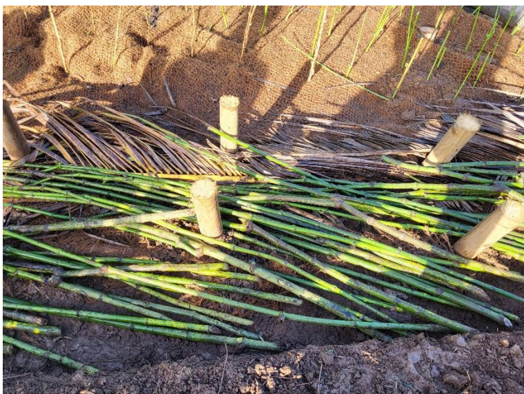
Figure 2-5: Mise en place des couches de branches en alternance avec des couches de terre assurant le bon contact entre les branches et la terre © André Evette
